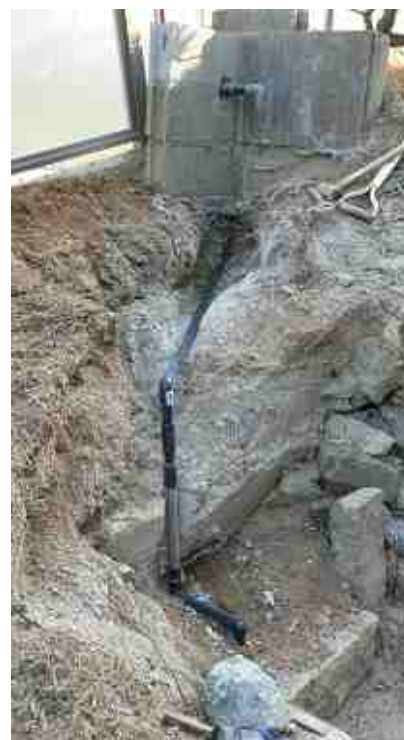
ドレーン用配管
