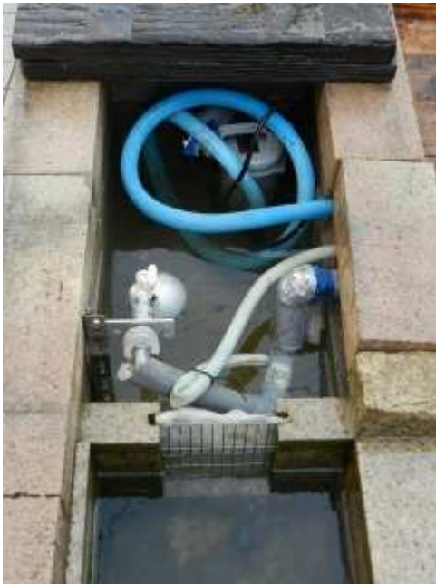
ポンプ室内部
