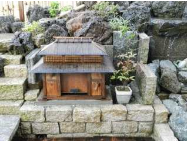
山門風分電盤カバー（内部に分電盤がある）
