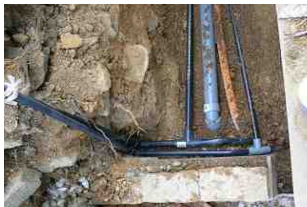
暗渠部の配管
