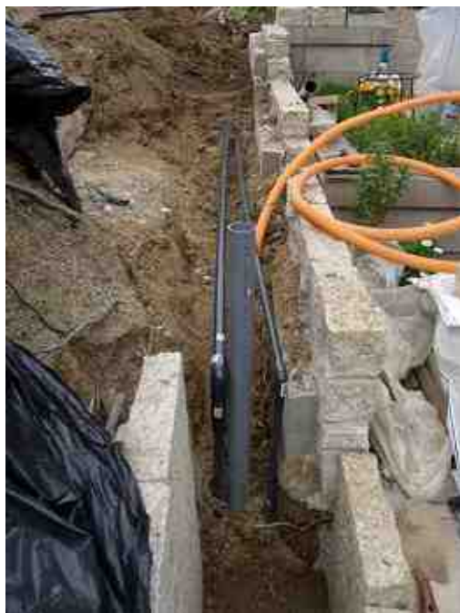
中池下をくぐる配管
