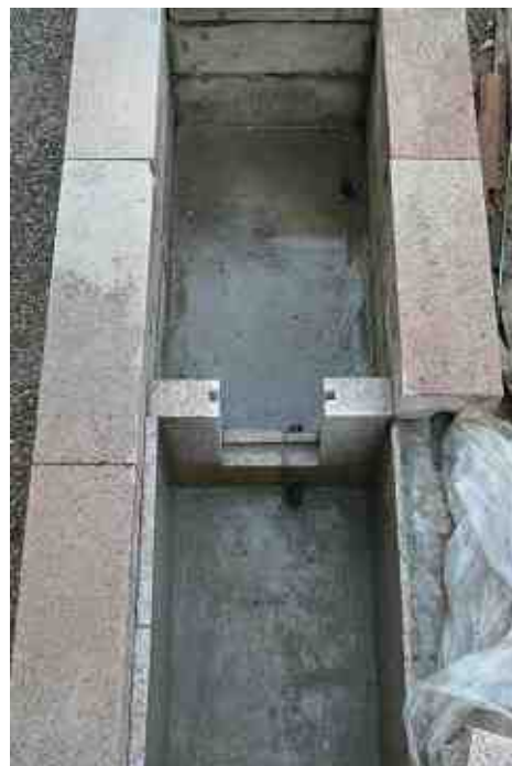
手前が貯水槽・向う側がポンプ室
