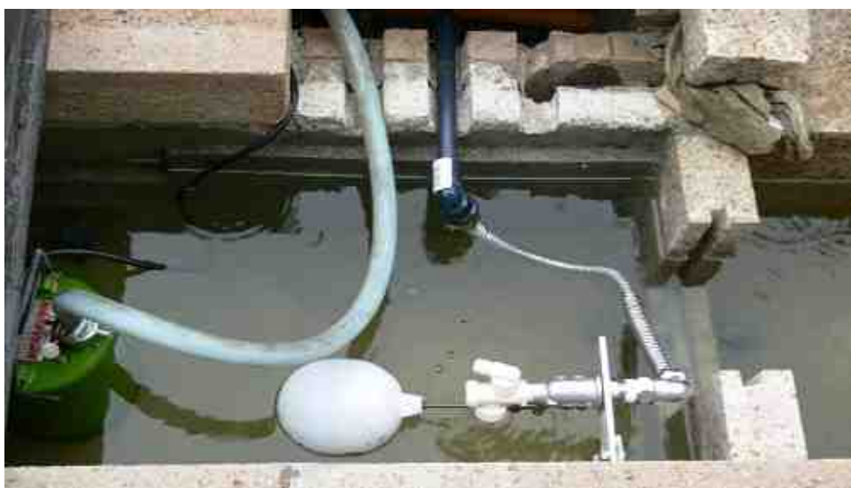
ポンプ室内の配置状況
